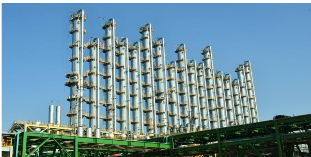
永祥新能源高纯晶硅精馏塔装置
